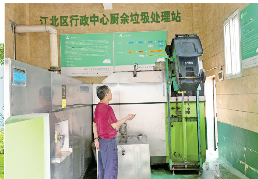
▲区行政中心厨余垃圾处理站，每天可接纳1吨左右厨余垃圾，每周可出产400斤左右高效有机肥。记者 刘陶然 摄
