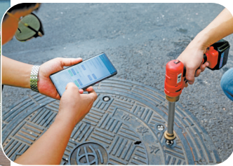
▲图为市政工作人员用手机给电动钥匙发送手机钥匙信号，用来打开智能井盖。
